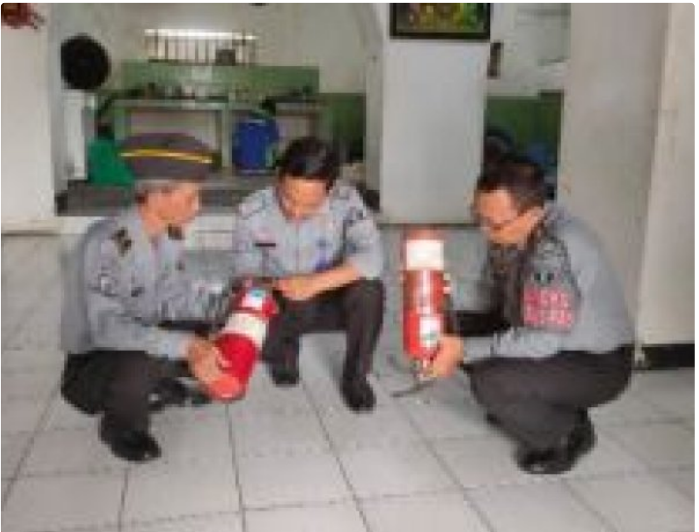
Petugas Lapas Ambarawa Lakukan Pengecekan APAR Antisipasi Kebakaran
